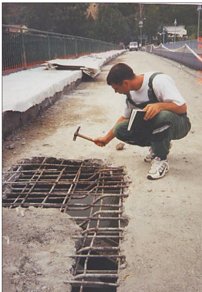
Tokaji Erzsébet királyné Tisza-híd felújítás közben kiszakadt pályalemez
